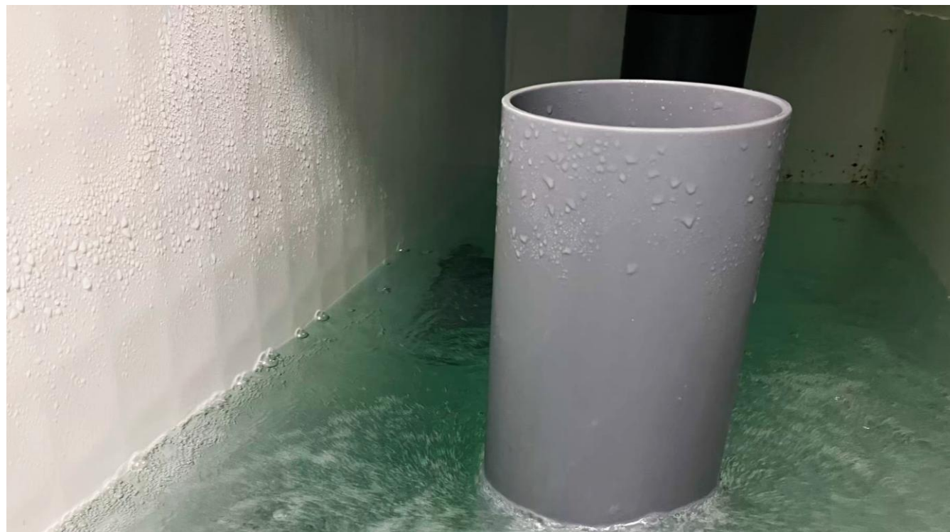
水位の不安定
